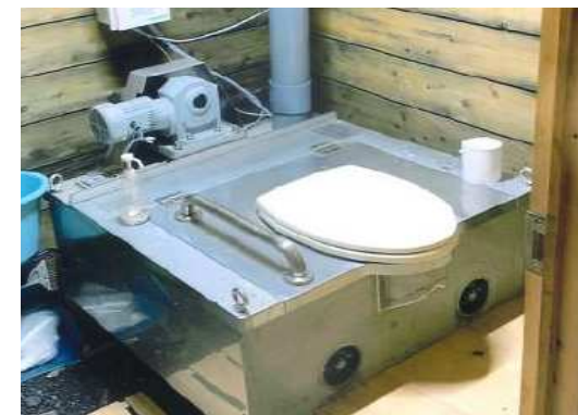
山小屋バイオトイレ
