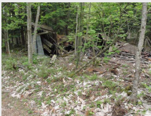
＜実施前＞ 倒壊した山小屋
