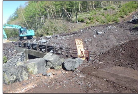
写真 2023年の土砂流出状況
