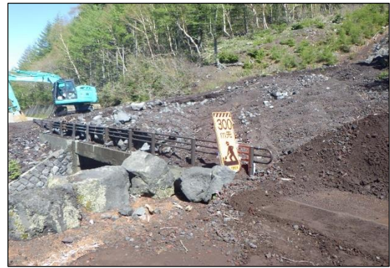
写真 2023年の土砂流出状況
